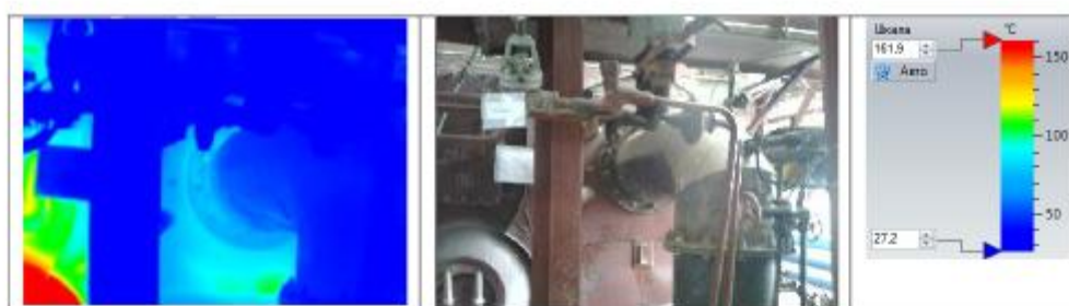
Рис. 3. Состояние элементов тепловой изоляции котла ДЕ-25
